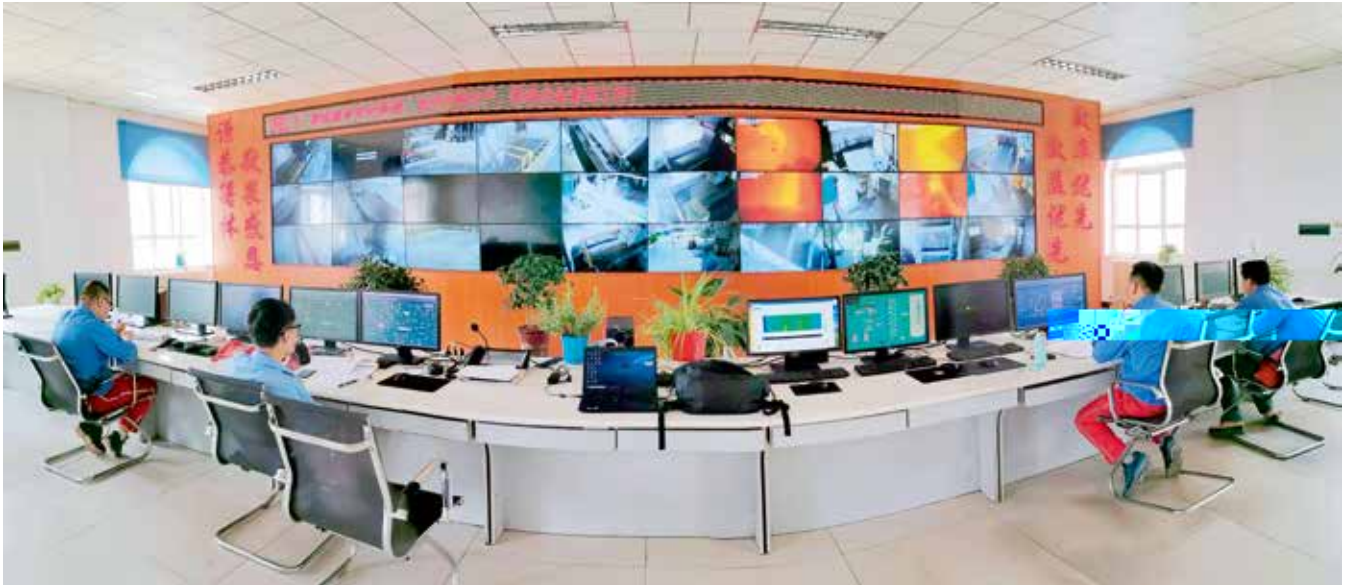
太阳山生产区中控室
