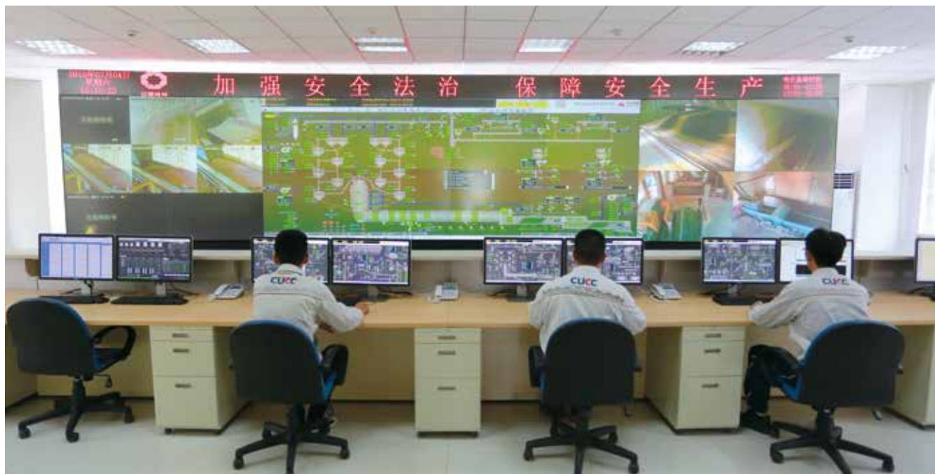
全智能熟料生产线监控调度中心
